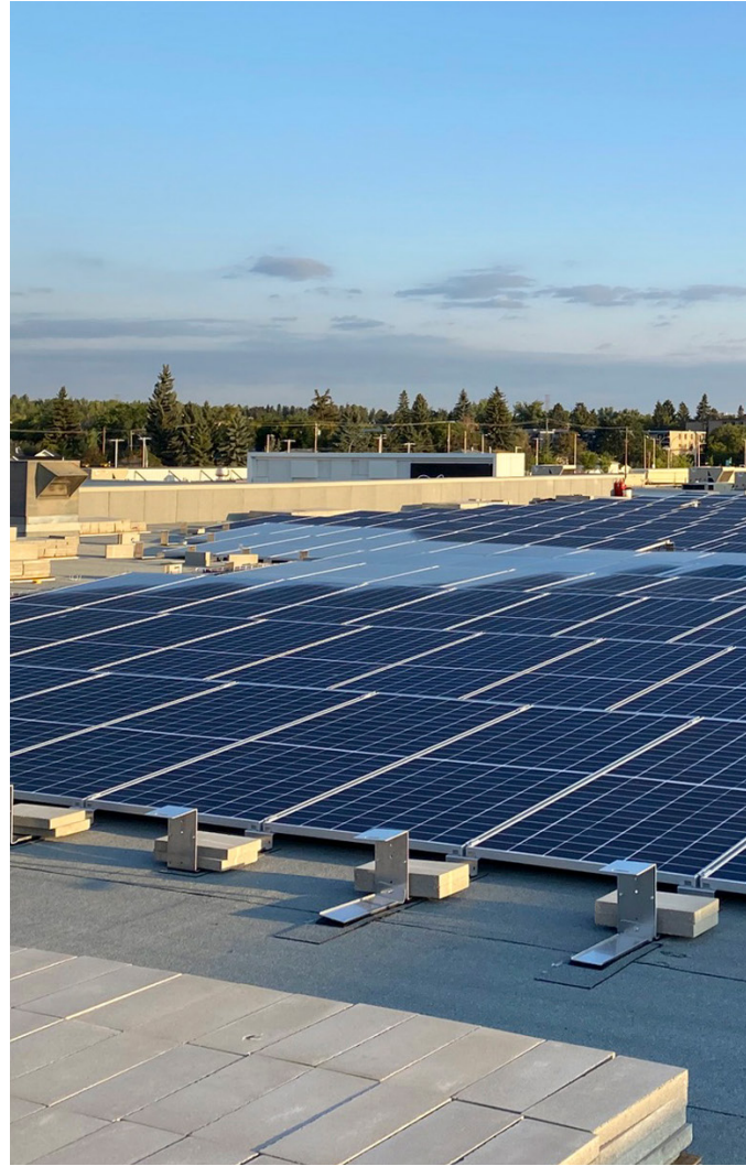
Panneaux solaires à CF Chinook Centre (Calgary, en Alberta)
